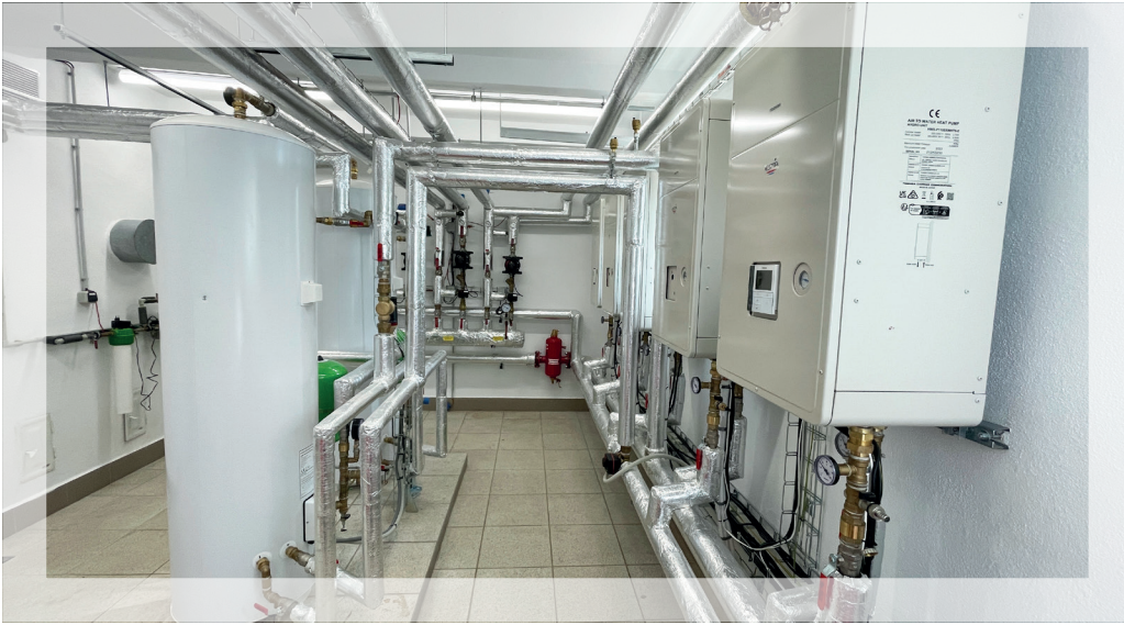
Kotelna s tepelnými čerpadly – správní budova ředitelství Hodonín
