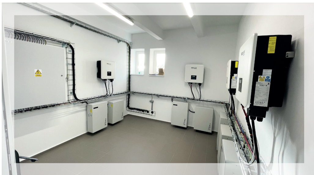
Rozvodna FVE – správní budova ředitelství Hodonín
