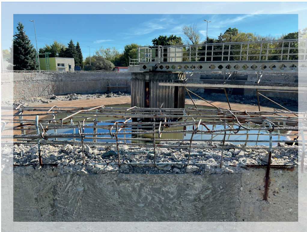
Usazovací nádrž – ČOV Hodonín před sanací
