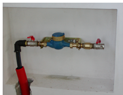
umístění vodoměru v nice objektu
