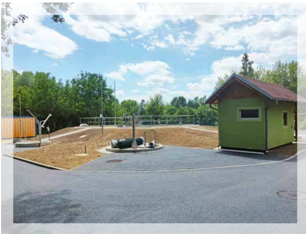
ČSOV a výtlačný řad Rohatec
